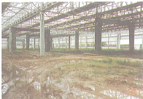
Rys. 7.1. Stan przed przedudową. Wnętrze hali B-50, wiosna 1993 – pusta konstrukcja słupowo-ryglowa (fot. D. Theuerkauf'93)
