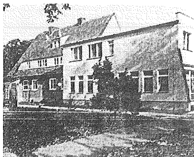
Przebudowa budynku stołówki — zmianie ulega piętro i powstaje nowe wejście do sali konsumpcyjnej
